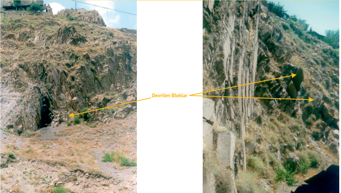
Şekil 2.16. Altındağ (Ankara) bölgesinde meydana gelen kaya devrilmesi türündeki duraysızlığa bir örnek (Foto: M. Ercanoğlu).
